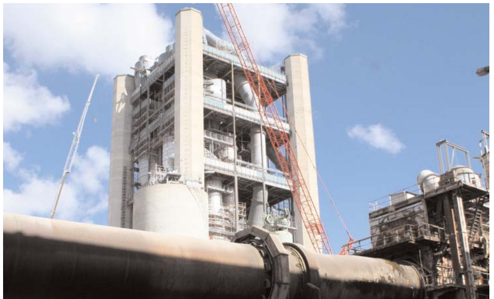
Der Steigrohrtrockner im Werk Lägerdorf hat eine Höhe von 60 Meter.
